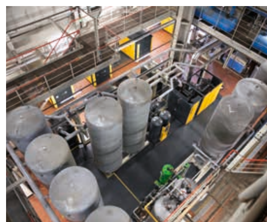
Dos sistemas de tratamiento diferentes secan el aire comprimido al nivel necesario para su uso.
