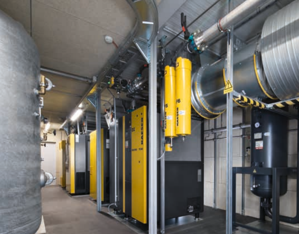
El contenedor en el que se encuentra alojada la estación de aire comprimido está completamente recubierto con material insonorizante para respetar los límites de emisiones sonoras.
