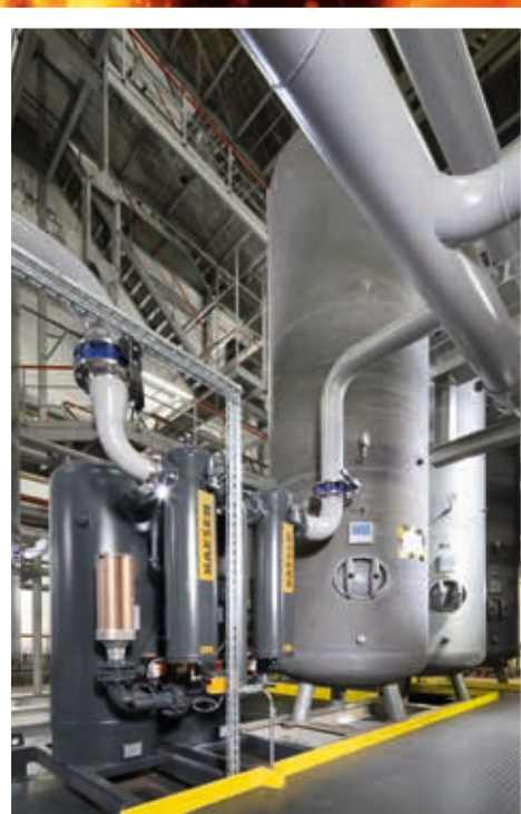
Ocho depósitos de aire comprimido almacenan un total de 70,000 litros.
