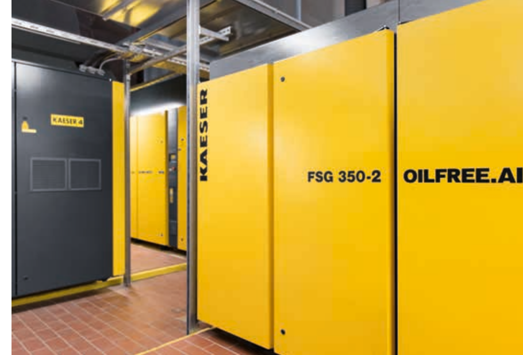
El aire comprimido cumple funciones vitales en la planta de Hannover. Sirve, entre otras cosas, para el transporte del óxido de plomo.
